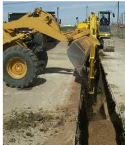
Figura 2. Posizionamento di una miscela di EHC e sabbia all'interno di una trincea per la realizzazione di una PRB per il controllo del pennacchio di contaminazione.
