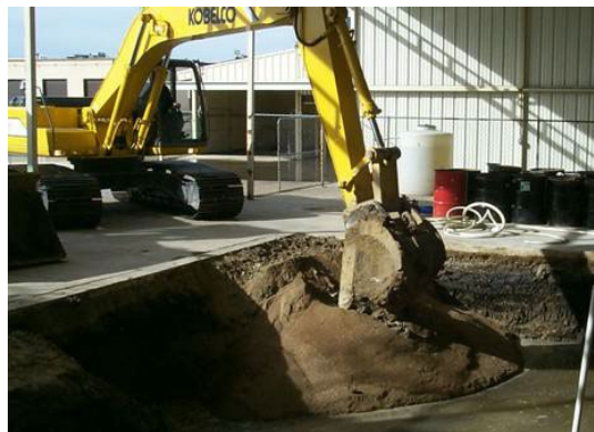
Figura 1. Materiale di riempimento con il 5% in peso di EHC in uno scavo aperto, dopo la rimozione della sorgente primaria.
