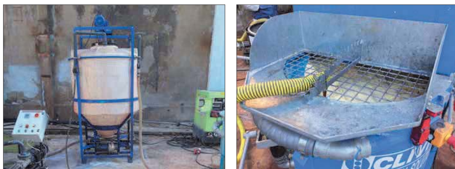
Figura 7. Vasca di pre-miscelazione (a sinistra) e vasca di miscelazione finale con sistema di ricircolo in linea (a destra)
